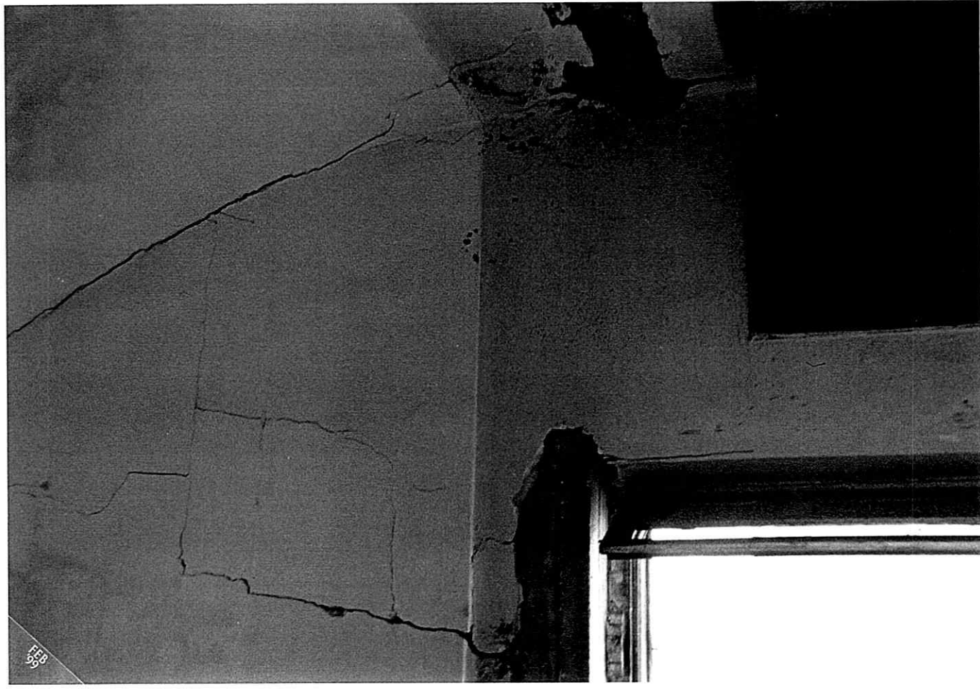
Immobile vico Morranza Particolare dissesti volta a padiglione
