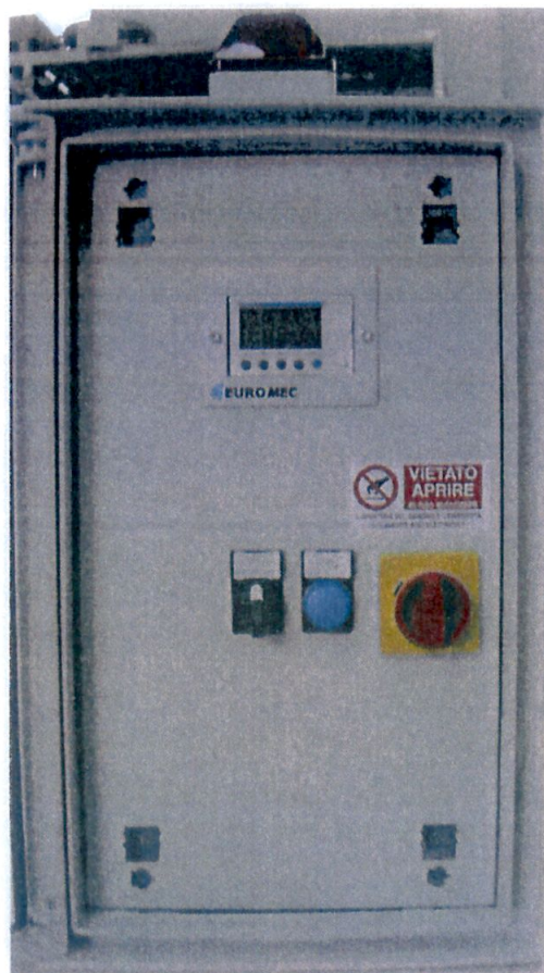
Foto 2 Quadro elettrico standard di comando (IP65)
