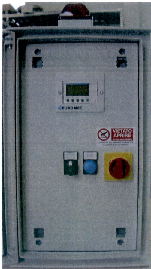
Foto 2 Quadro elettrico standard di comando (IP65)
